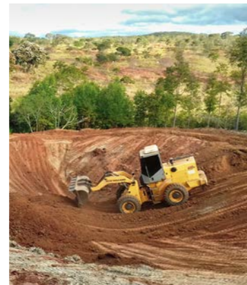
Dank Wasserbecken können Kleinbauernfamilien Regenwasser speichern und länger in die Trockenperiode hinein ihre Felder bewässern. Dadurch verlängert sich ihre Produktionszeit.
